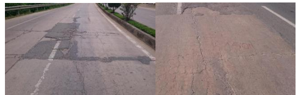
Hình 1. Hư hỏng (phá hoại môi) mặt đường BTXM trên Quốc lộ 1A, đoạn qua thành phố Quảng Ngãi
