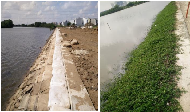
Hình 9. Bảo vệ bờ chống sạt lở cho đoạn bờ sông Kinh tại Thành phố Hồ Chí Minh
