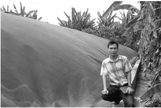
Hình 2. Hầm biogas trang trại Hòa Phú TP. Đà Nẵng
