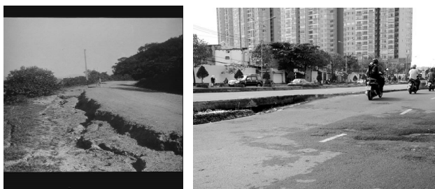
Hình 1. Sự cố lún nền đường đắp trên đất yếu
