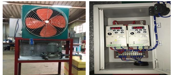
Hình 4. Mô hình thí nghiệm làm mát bay hơi nước và biến tần điều khiển bơm và quạt
