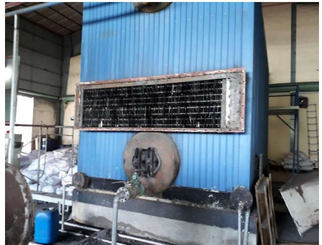
Hình 1. Hình ảnh bộ hâm nước lắp vào lò đốt than
