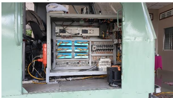
Hình 3. Khối điều khiển thu hoạch sử dụng các PLC
