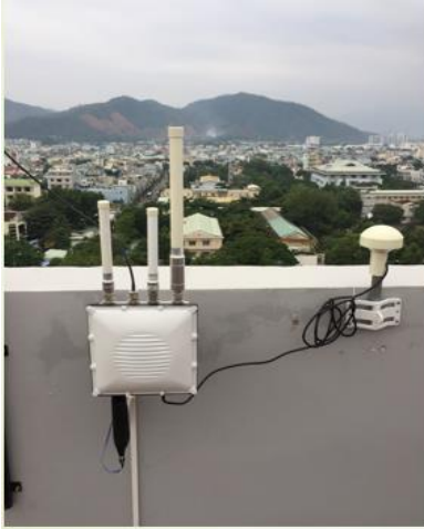
Hình 6. Gateway được lắp đặt để thử nghiệm
