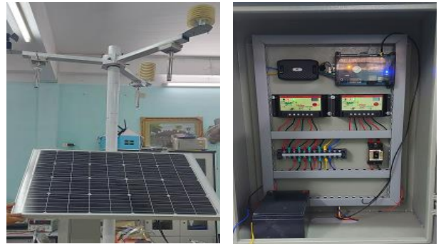
Hình 8. a) Trạm quan trắc lắp đặt thực tế và b) tủ điện đầu nối
