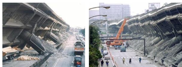
Hình 1. Hư hỏng kết cấu trụ cầu dẫn đến sụp đổ hoàn toàn công trình sau động đất Kobe 1995 ở Nhật Bản [3]
