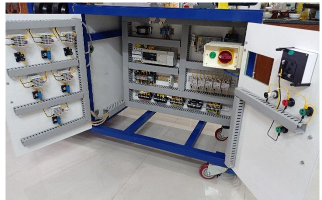
Hình 17. Hệ thống điện thực tế sau khi lắp đặt
