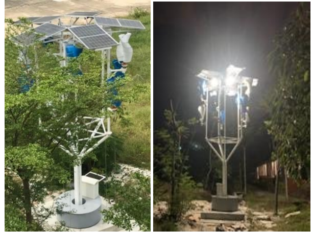
Hình 13. Cây năng lượng được lắp đặt thực tế
