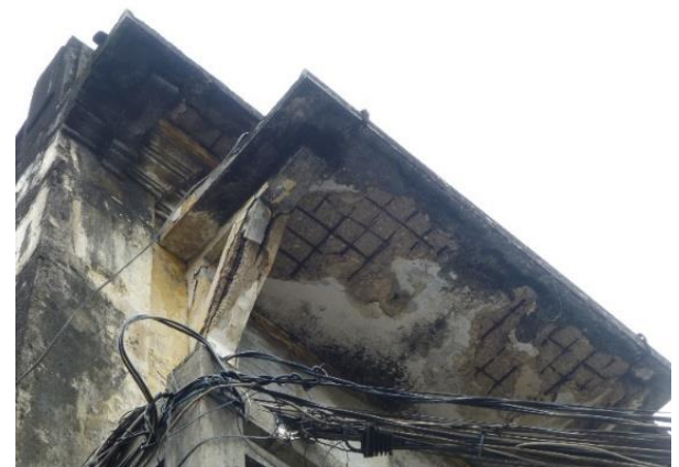
Hình 4. Nhà ở số 46 Chi Lăng (Huế) hư hại nghiêm trọng của lớp sàn dầm (nguồn: hình chụp của NTG)
