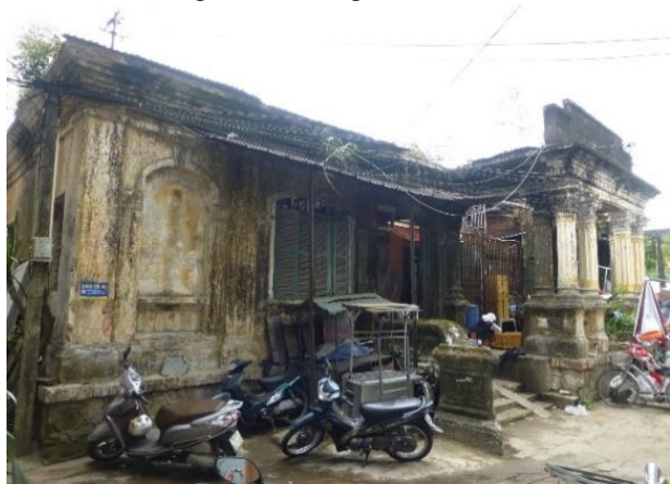
Hình 3. Một công trình thuộc địa ở kiệt 31 Trần Hưng Đạo (Huế) xuống cấp trầm trọng và đang không sử dụng (bỏ hoang) do thiếu cơ chế (nguồn: hình chụp của NTG)
